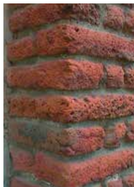
Sablage abusif de la brique
