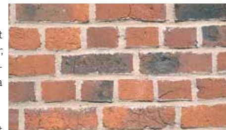
Joints débordants et trop clairs annulant la qualité de cette maçonnerie de brique
