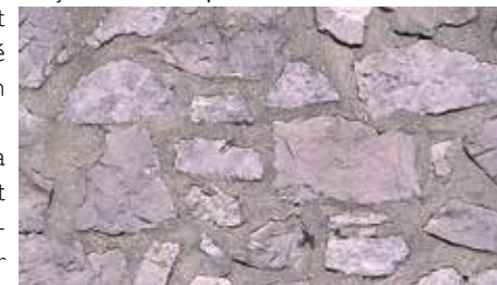
Le cimentage ou tranchée des joints donne l'irrégularité de mur de moellons
