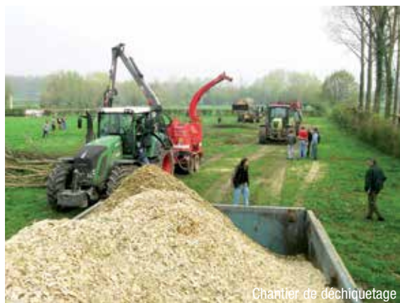
Visite d'une chaufferie au bois déchiqueté
