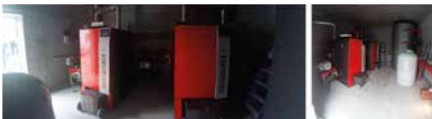
Approvisionnement de plaquettes de bois (± 100m3/an) et Chaufferie à la caserne -Clarke à Landrecies
