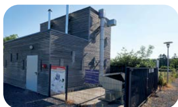
Chaufferie de Wallers-en-Fagne alimentant 6 bâtiments communaux
